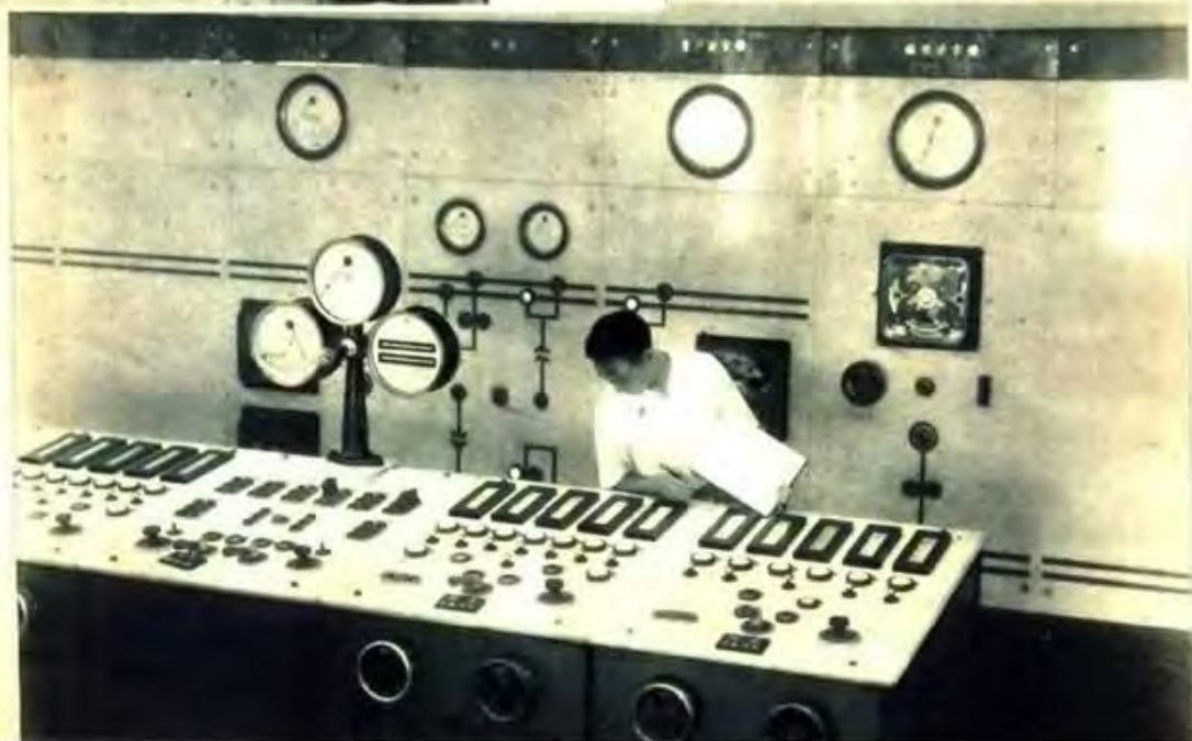
→ 電 氣 控 制 間 —— 由 此 將 電 輸 送 各 用 戶。 ↑ 配 電 間。
